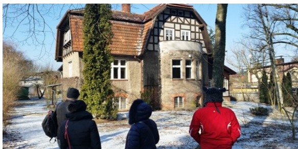
Fot.1 Wymagający remontu oraz nadania mu nowych funkcji zabytkowy budynek mieszkalny (obecnie niezamieszkały).
